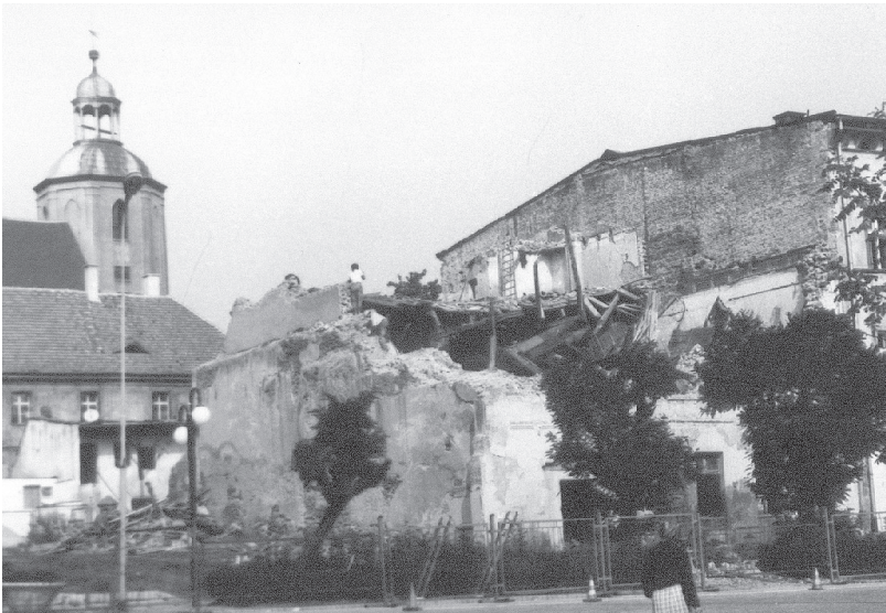
Ryc. 6. Kamienica Sachsen po zawaleniu się stropów i rozpoczęciu robót rozbiórkowych. Stan w październiku 1995 r. (fot. M. Furmankiewicz).
